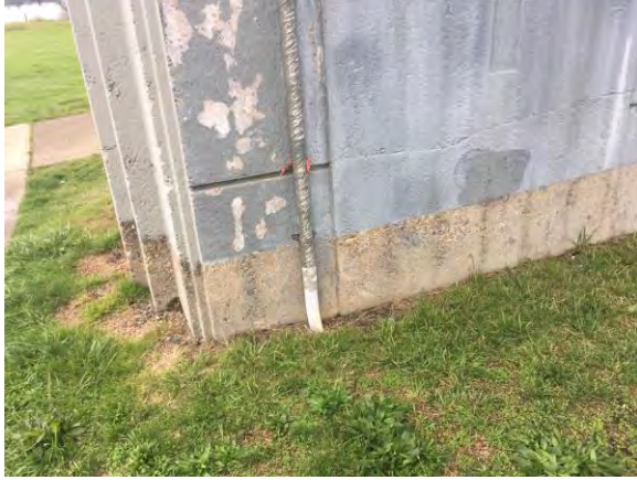
Picture #25. Electrical conduit
